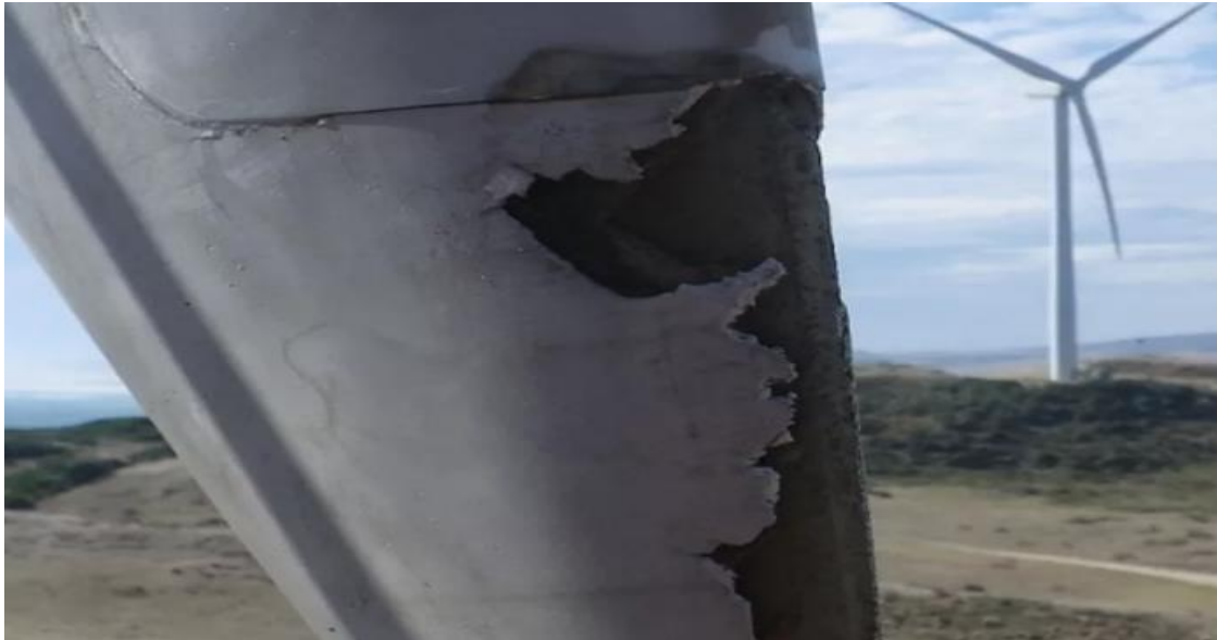
Erosion am Rotorblatt, Quelle Seilpartner Windkraft aus KeyWindEnergy
